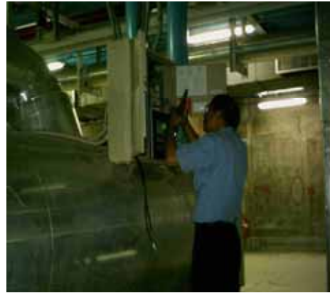
<8> 空調主機控制盤
