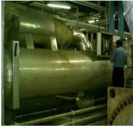
<7> 空調主機控制盤
