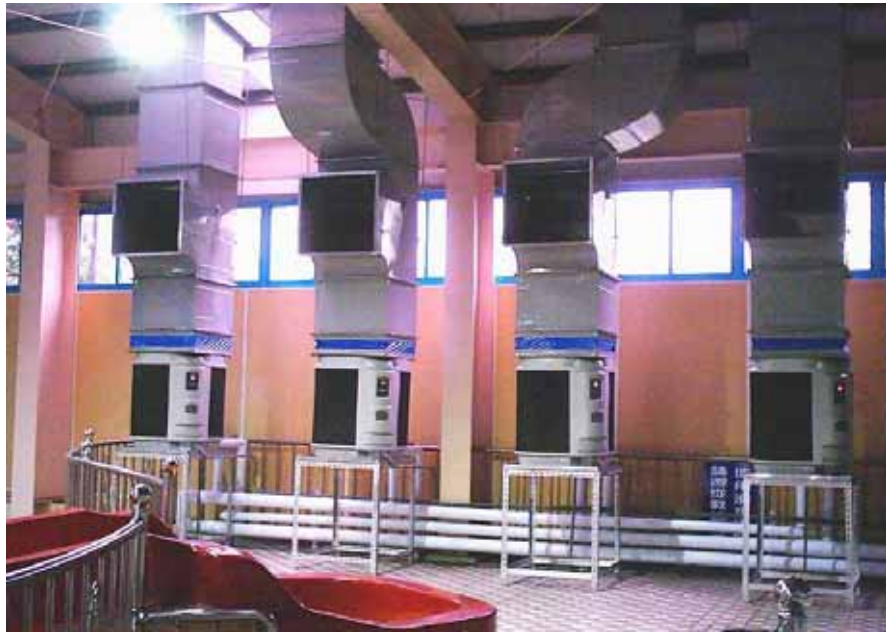
相片 5-1 休閒館游泳池空氣對水熱泵系統
