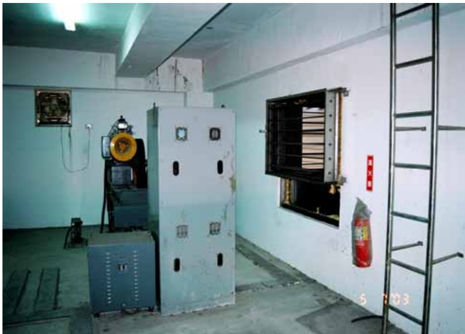
圖 4.7-3 千禧大樓之電梯機房
