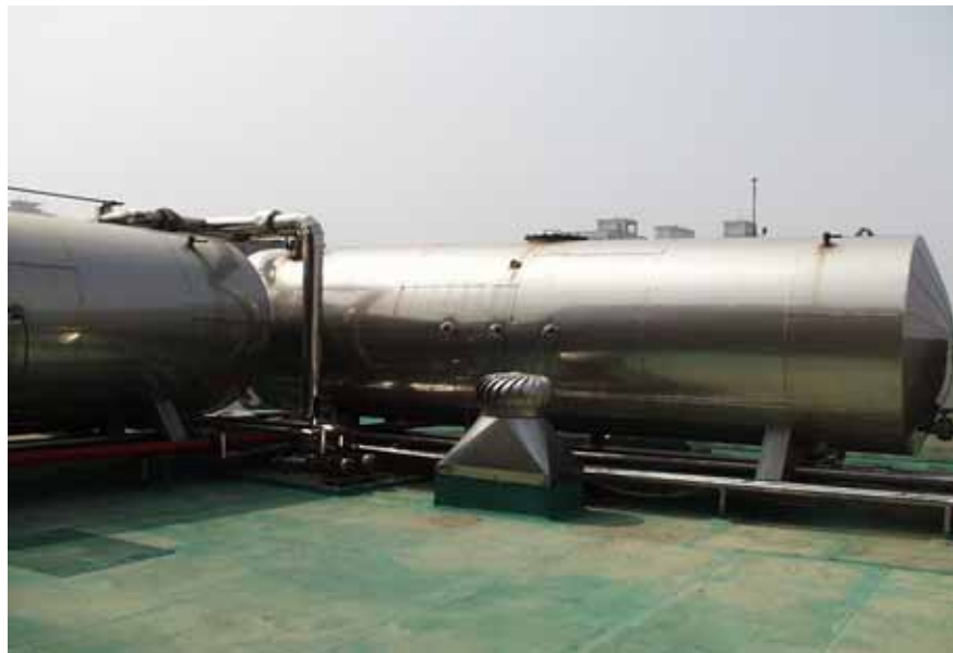
相片 5-4 學校宿舍熱泵熱水儲槽(10 噸*2)
