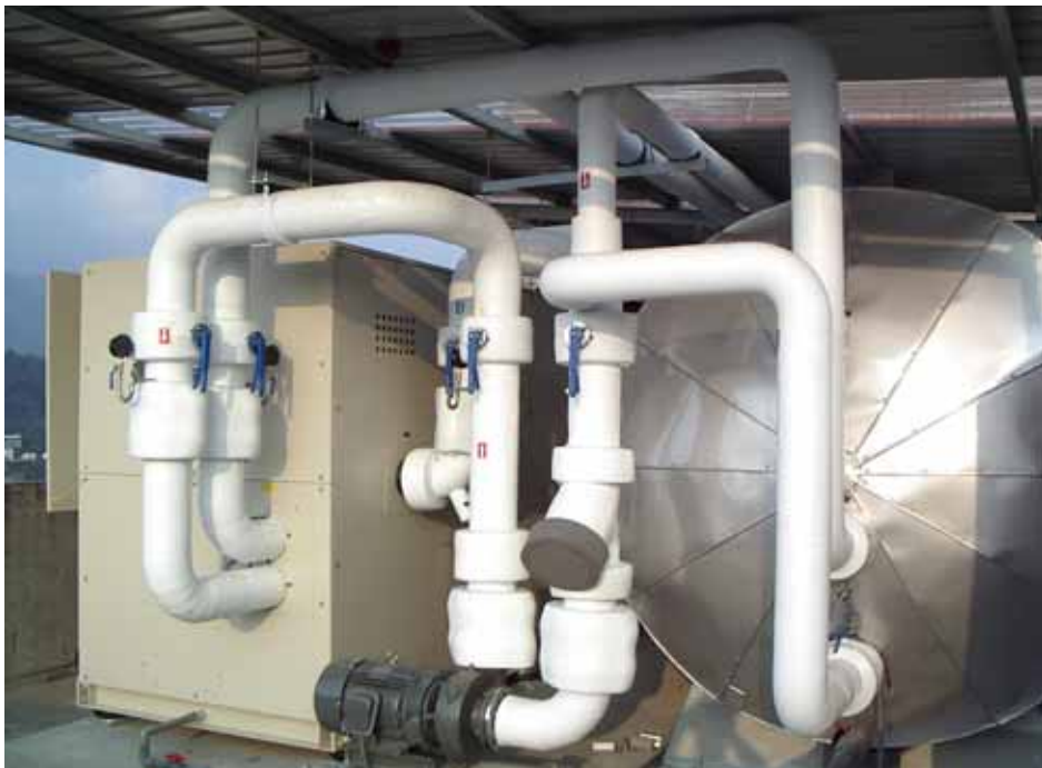
圖 4.2-5 熱泵主機與熱水儲槽
