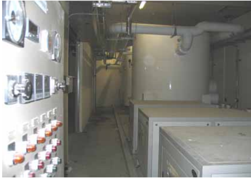
相片 5-7 某高雄復健大樓熱泵熱水系統
