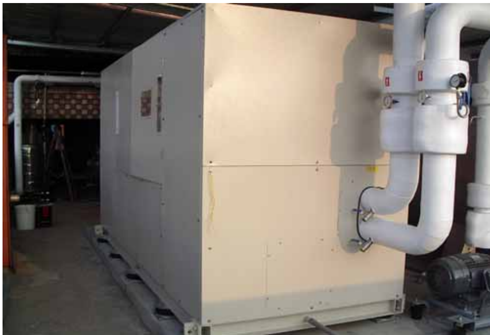
圖 4.2-3 鎮寶大飯店熱泵系統主機
