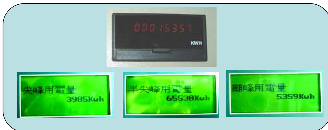
掛錶記錄熱泵在各用電時段之耗電量
