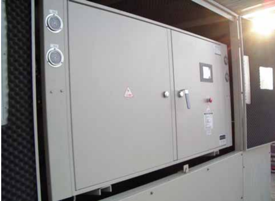
圖 4.2-4 鎮寶大飯店熱泵系統主機
