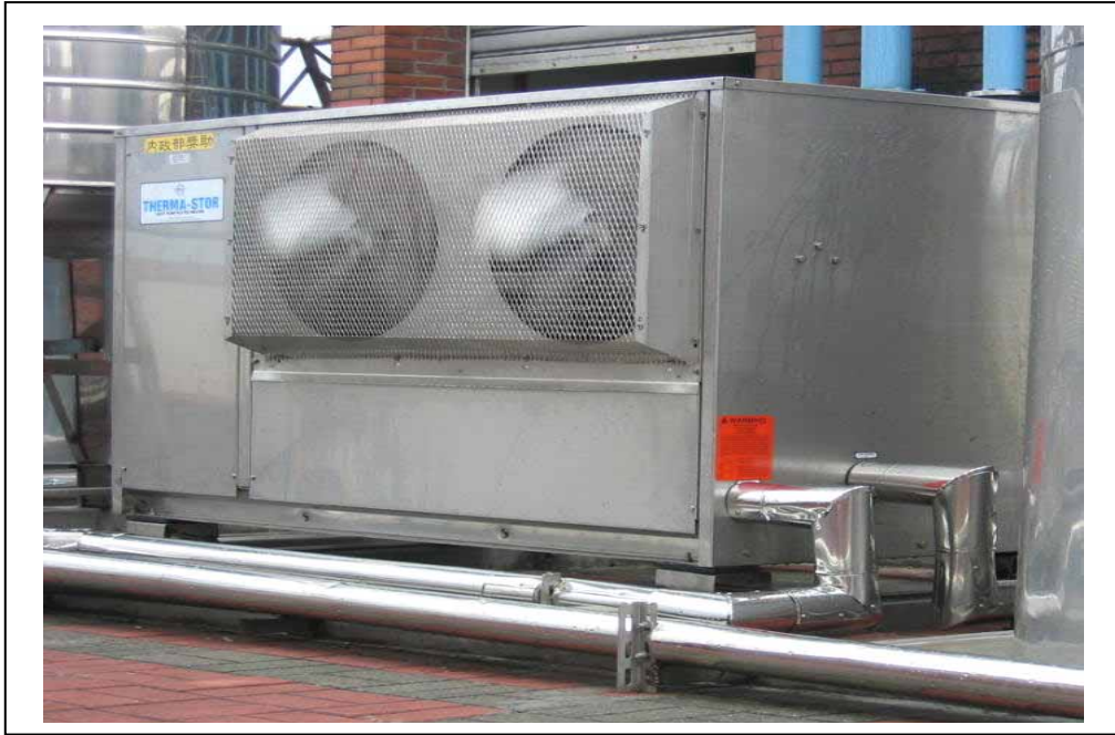
圖 4.8-2 雙連安養中心熱泵系統主機
