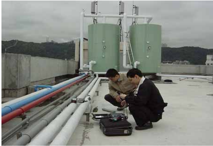
相片 5-5 宿舍熱泵熱水系統效率測試(明日之星)
